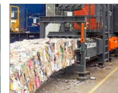
Installation dans un centre de logistique
